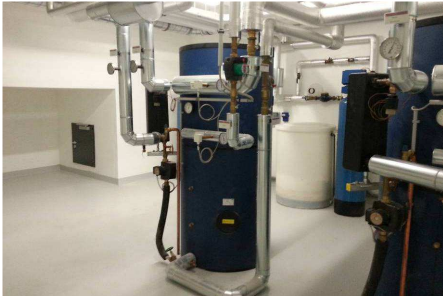
Abb. 82: Heizraum der Uckerseehalle
