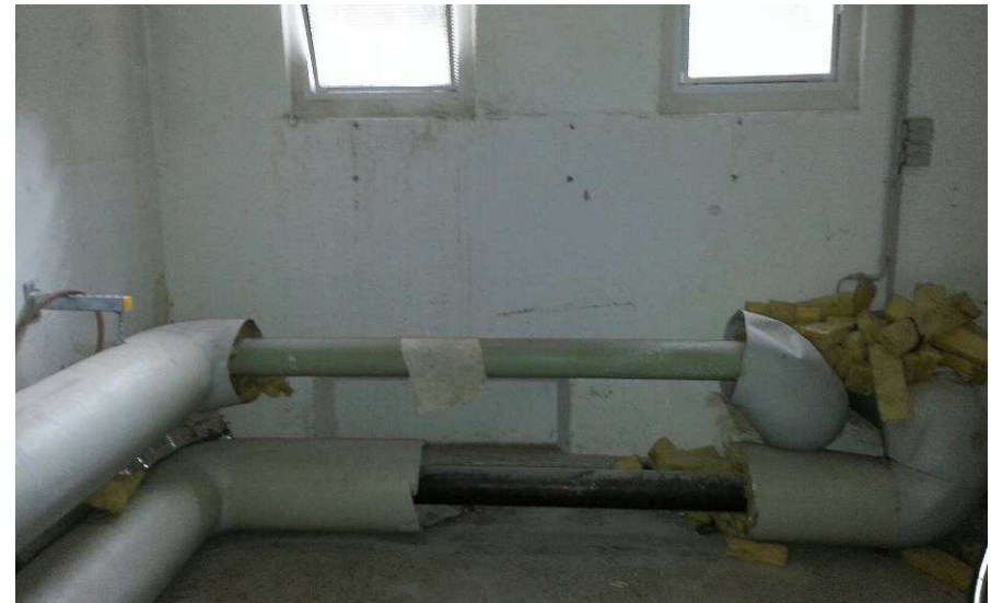
Abb. 45: seit mindestens 10 Jahren fehlende Dämmung an den Fernwärmeleitungen
