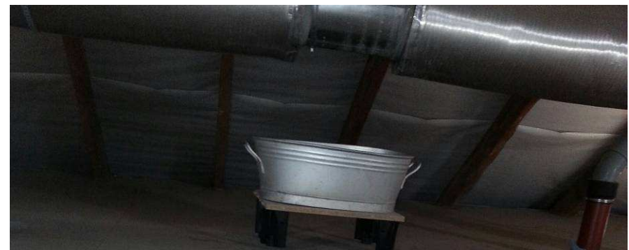
Abb. 34: Kondenswasserauffanggefäß an der Abluftanlage
