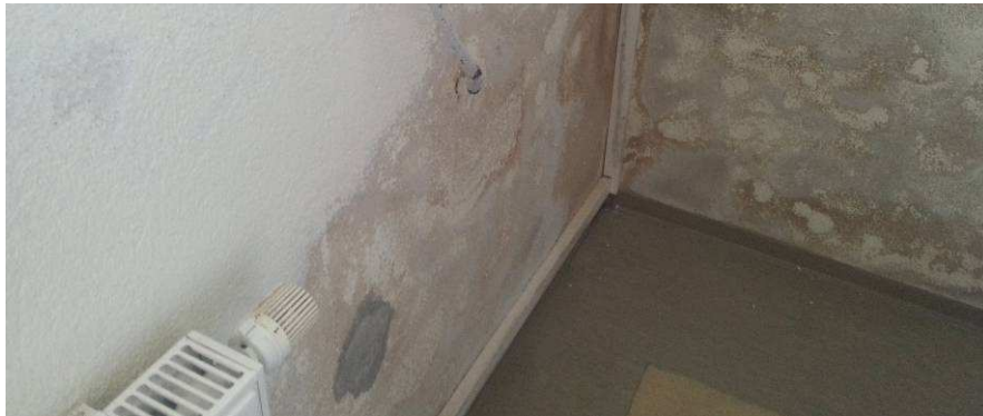
Abb. 69 Feuchtigkeitsschäden im Keller/Archivraum
