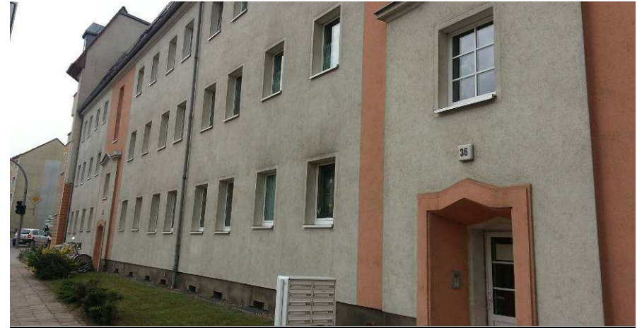
Abb. 47: Straßenfassade mit mikrobiellem Befall
