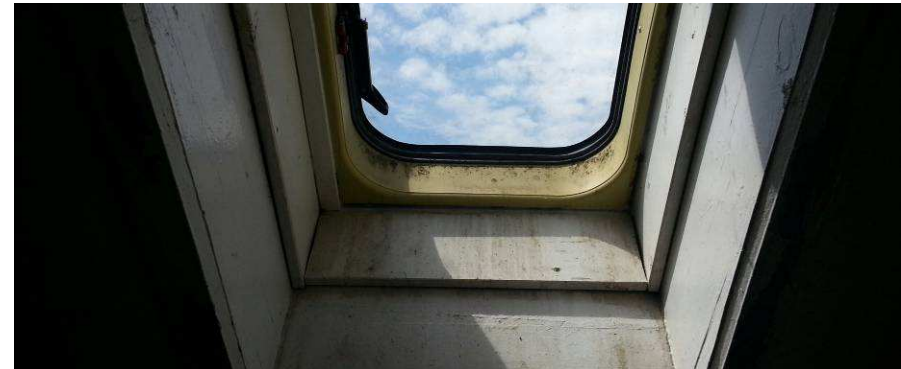
Abb. 33: Einfachverglastes Fenster mit Kondenswasserspuren im Treppenaufgang
