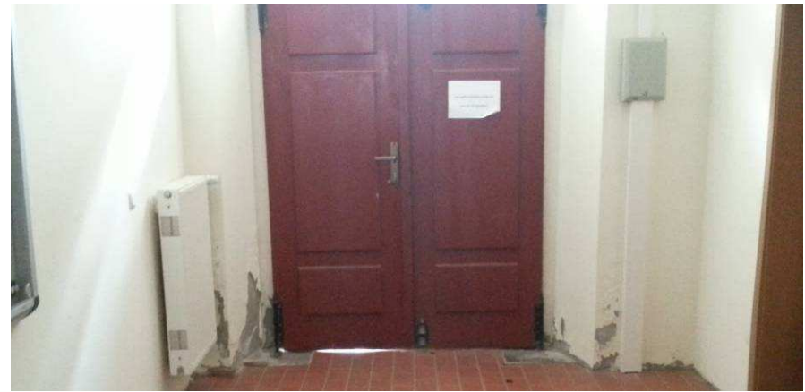
Abb. 65: Türundichtigkeiten und Feuchtigkeitsschäden am Mauerwerk
