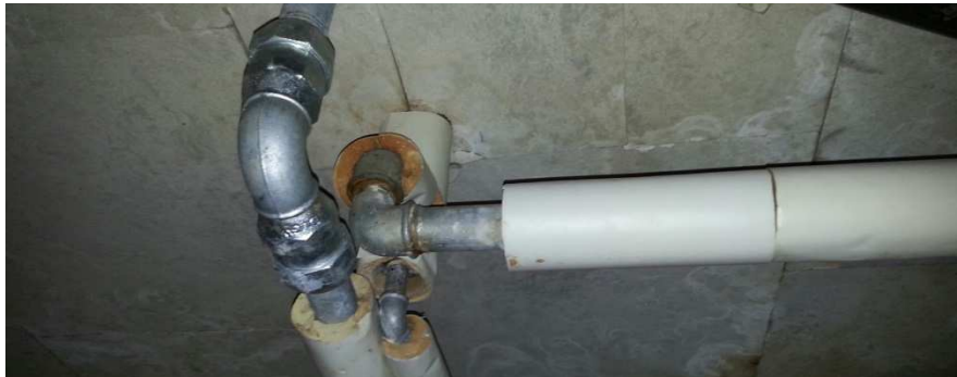
Abb. 39: Fehlstellen in den Leitungsdämmungen und unzureichende Dämmstärken
