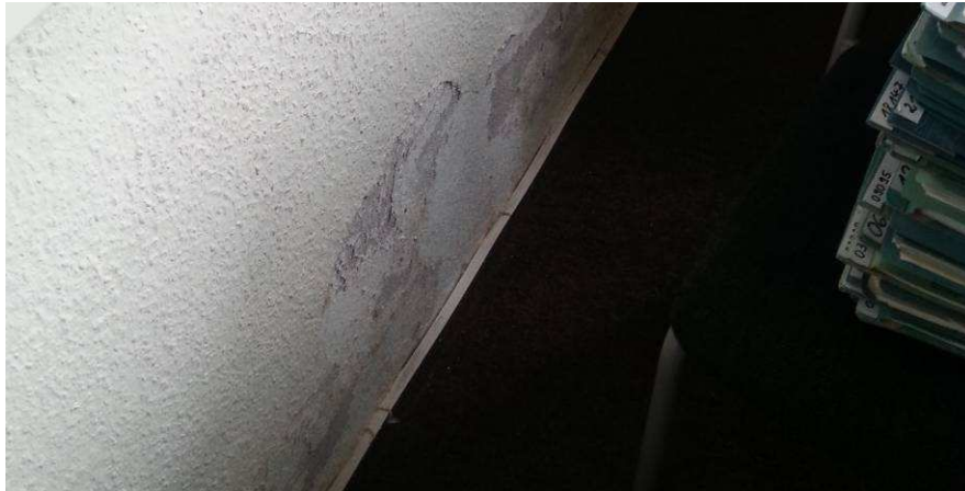
Abb. 75: Feuchtigkeitsschäden in Büroräumen durch fehlende Abdichtungen
