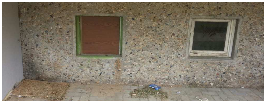
Abb. 36: bauzeitliche Fenster und Fehlteile im Kellergeschoss
