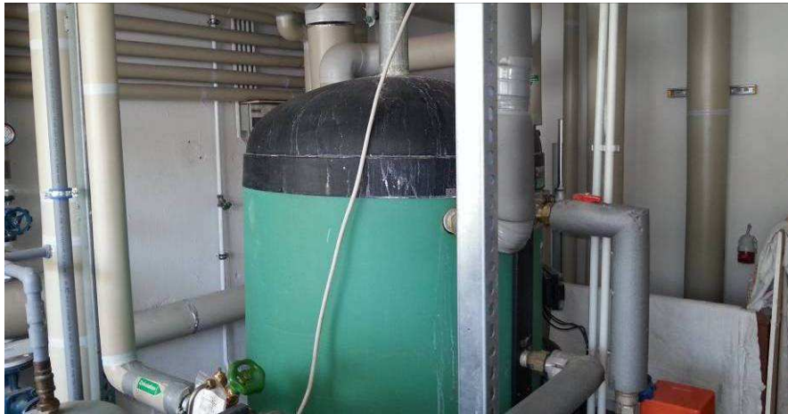
Abb. 62: Fernwärme-Übergabestation mit Warmwasserspeicher
