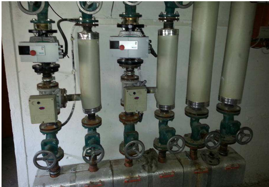
Abb. 32: unzureichend gedämmte Heizkreisverteilung
