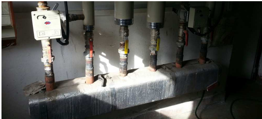
Abb. 49: Dämm-lücken am Heizkreisverteiler
