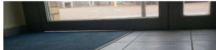
Abb. 71: fehlende Bodendichtung an der Eingangstür
