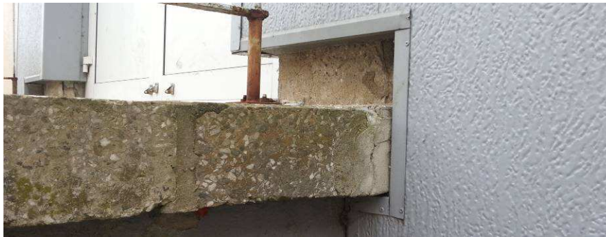
Abb. 86: Wärmebrücke im Treppenbereich
