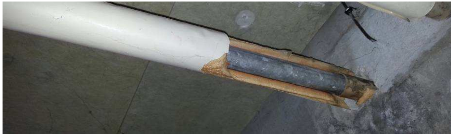
Abb. 38: Fehlstellen in den Leitungsdämmungen
